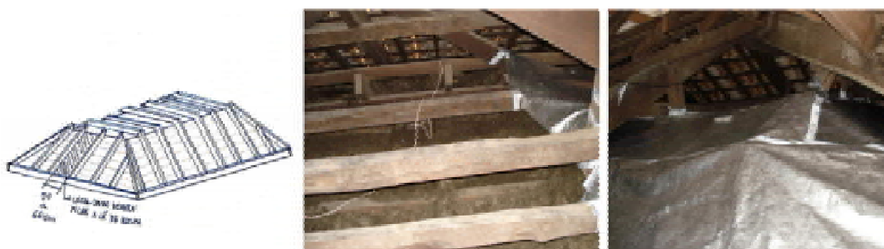
Figura 2: Desenho esquemático do forro do Salão Nobre e detalhe da colocação da lã de rocha sobre o forro e da manta contínua de Tyvek. Desenho e fotos da autora.
