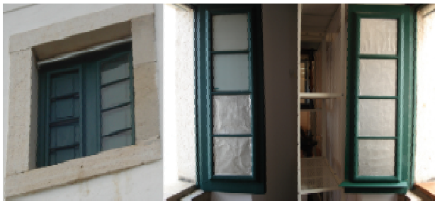
Figura 3: Caixilhos originais da sala, teste com diferentes tipos de películas de materiais opacos e caixilho pronto com aplicação de Tyvek, para reduzir carga térmica
