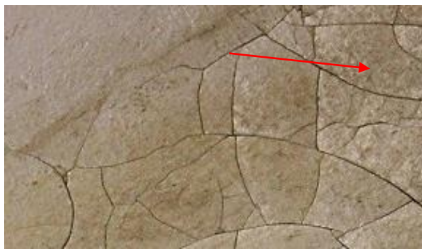
Fotografia 235- Detalhe de área antes da restauração.
