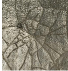
Fotografia 53- Craquelê localizado no paletó (detalhe).
