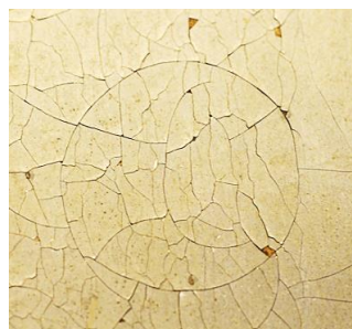
Fotografia 49- Craquelê localizado na área de fundo (detalhe).
