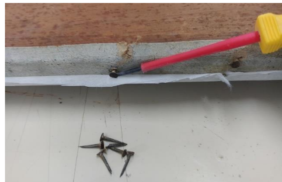
Fotografia 95- Afrouxamento das tachas. Verifica-se o tecido da tela que foi cortado assim como o furo na borda proveniente de outro prego.
