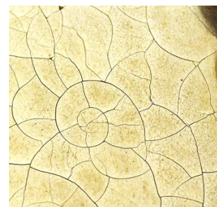
Fotografia 50- Craquelê localizado na área de fundo (detalhe).
