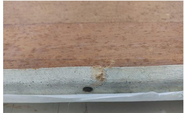
Fotografia 84- Detalhe do furo próximo à borda do tecido. Os fios estão rompidos.
