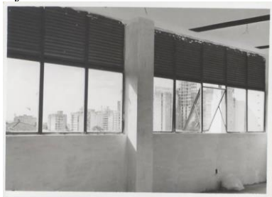
Figura 10– Vãos de todo o edifício, difícil controle ambiental
