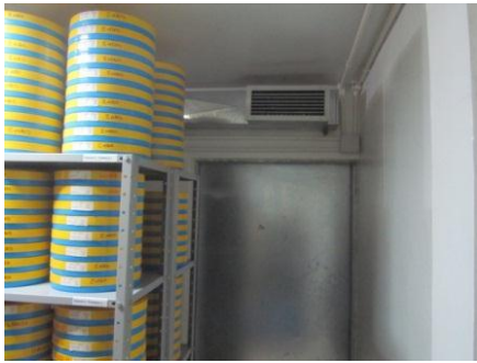
Figura 8 - Saída e tubulação de ar do sistema de climatização Sala Fundo TV Globo Minas. A autoria é própria, 2012.
