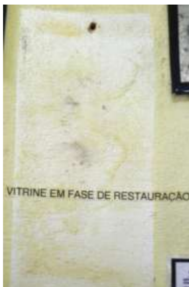
Figura 72: Local da vitrine retirada para restaurar
