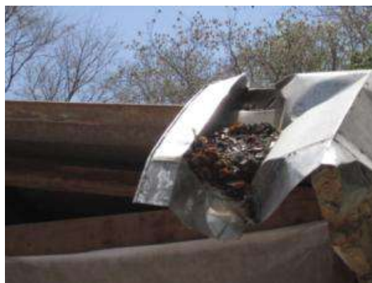
Figura 25 - Resíduos nas calhas
