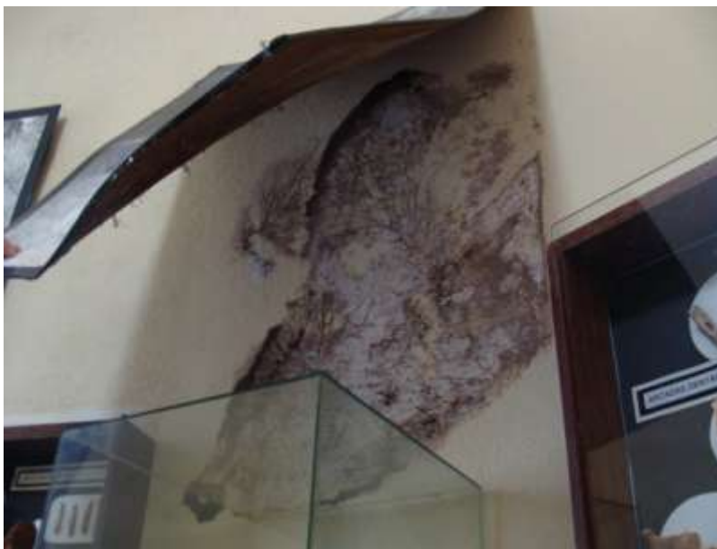
Figura 40 – Detalhe da infiltração na parede
