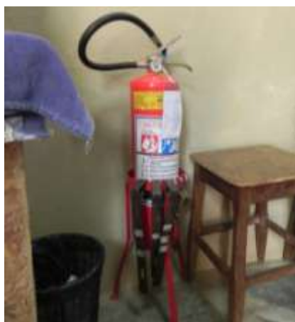
Figura 33 – Extintor de incêndios
