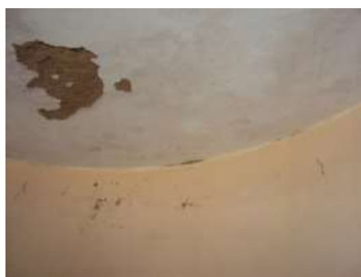
Figura 27 – Umidade no teto do 3º pavimento
