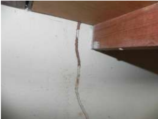
Figura 28 – Sinais de cupim de solo
