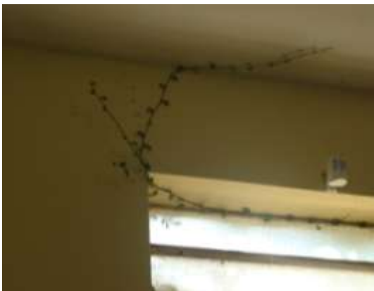
Figura 30 – Hera penetrando através da janela
