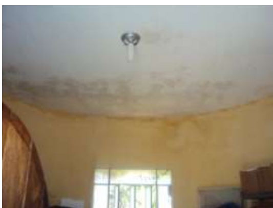
Figura 26 - Umidade no teto do 3º pavimento
