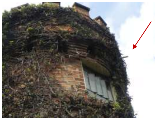
Figura 23 - Tubulação direto nas paredes
