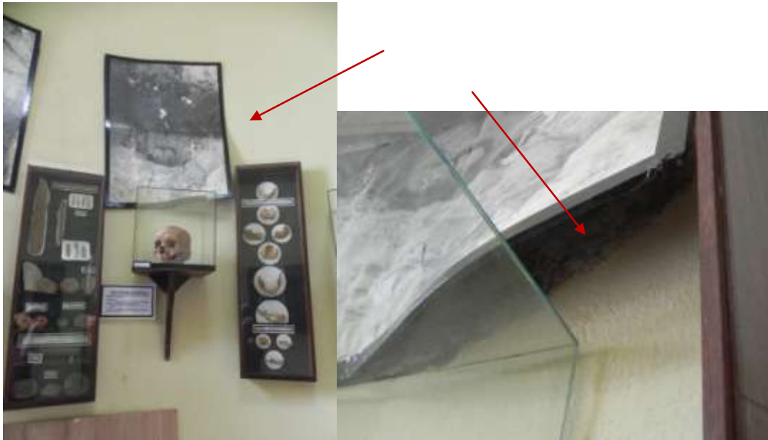
Figura 39 – Painel deformado devido á umidade da parede
