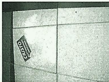
Foto 6. Sujidades e perda de rejunte (set.2011).
