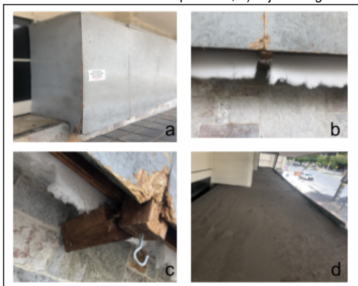
Figura 14: Deteriorações na Estrutura: a) falta de sinalização; b) perdas das placas de polietileno; C) instabilidade do compensado; d) sujidades generalizadas.
