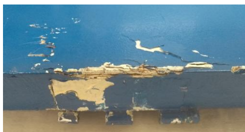
Figura 52: Desprendimento da madeira e de camada de tinta na lateral. Fonte: Fotos do autor, 2018.
