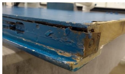
Figura 50: Fenda na parte inferior da porta e partes enferrujadas. Fonte: Fotos do autor, 2018.
