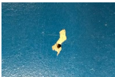
Figura 49: Buraco encontrado na parte inferior da frente da porta. Fonte: Fotos do autor, 2018.
