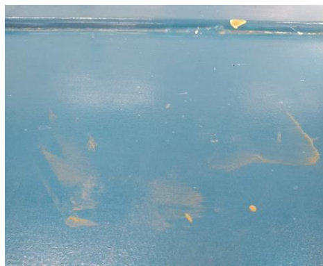
Figura 46: Presença de manchas de coloração marrom sobre a pintura da porta. Fonte: Fotos do autor, 2018.
