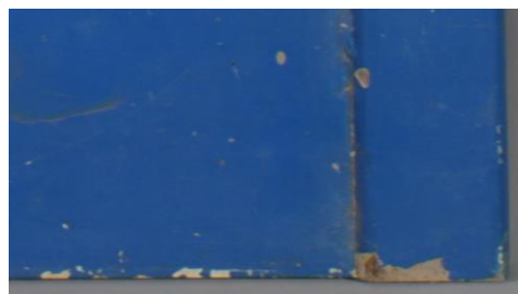
Figura 53: Desprendimento de tinta na parte inferior da frente da porta. Fonte: Fotos do autor, 2018.
