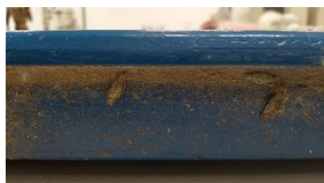
Figura 48: Detalhe da lateral da porta: presença de traças. Fonte: Fotos do autor, 2018.
