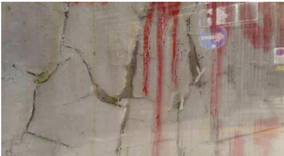
Figura 97: Detalhe das alterações sofridas – falta de transpiração, condensação e deposição de sujidades por conta da incorreta instalação de barreira física. Fonte: GARCIA, 2016, p. 93.
