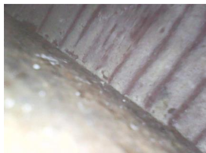
Figura 63: Imagem obtida por sonda da parte interna da porta. Fonte: Fotos do autor, 2018.
