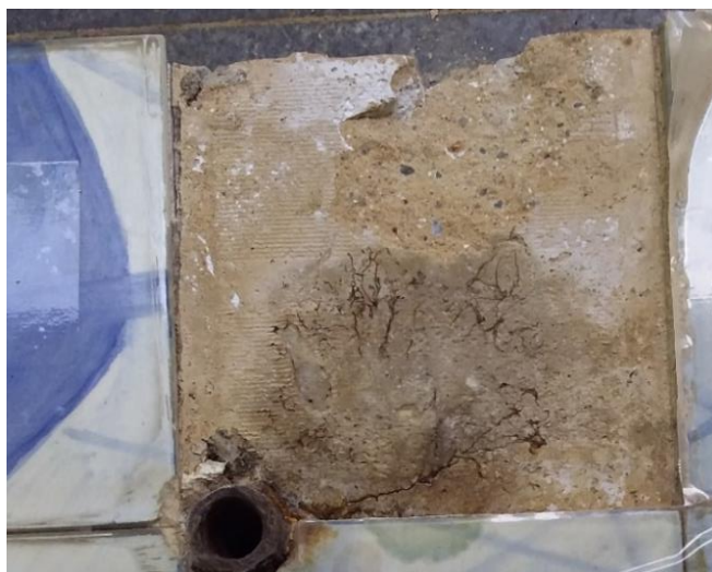
Figura 14 - Eflorescência salina em uma placa de alvenaria observada durante a remoção do painel.
