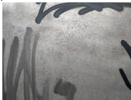
Figura 67 Marcas de impactos (lateral direita da obra).
