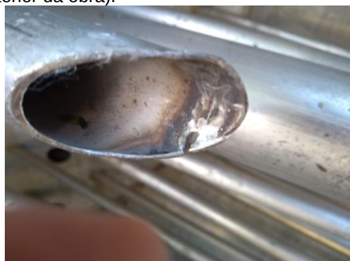
Figura 82 Perda de suporte no tubo (parte anterior da obra).
