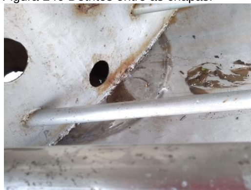
Figura 246 Detritos entre as chapas.
