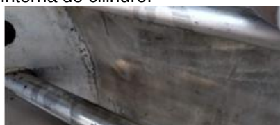
Figura 214 Oxidações na parte interna do cilindro.
