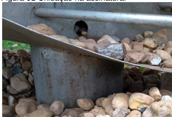
Figura 91 Oxidação na assinatura.
