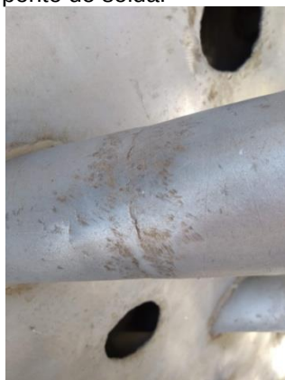
Figura 202 Oxidação em ponto de solda.
