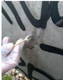
Figura 106 Manchas amareladas removidas com água (lateral direita da obra).
