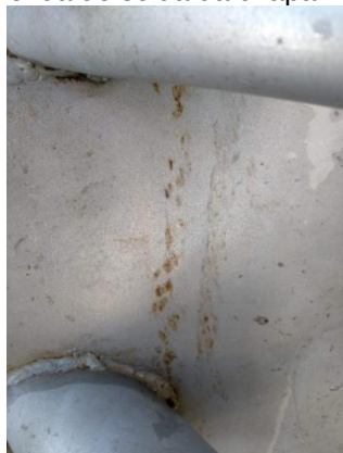
Figura 208 Oxidação em emenda de solda da chapa.
