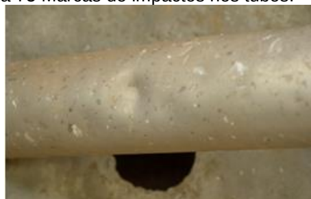
Figura 75 Marcas de impactos nos tubos.
