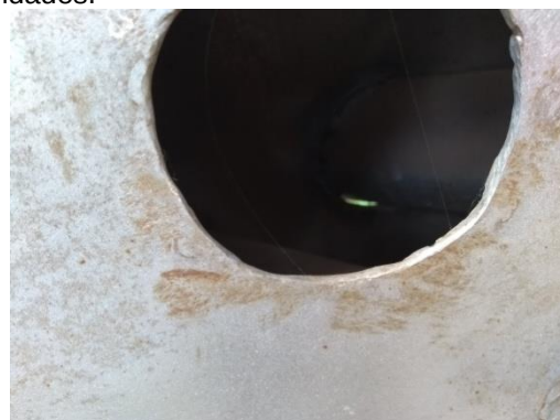
Figura 83 Tudo perpassando as placas com sujidades.
