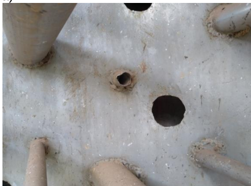
Figura 80 Perda de suporte (tubo) (frente da obra).
