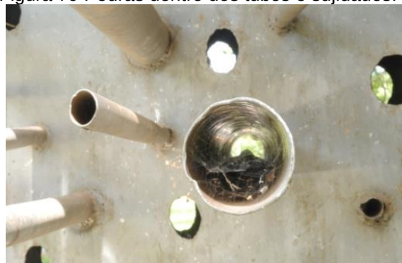
Figura 79 Pedras dentro dos tubos e sujidades.
