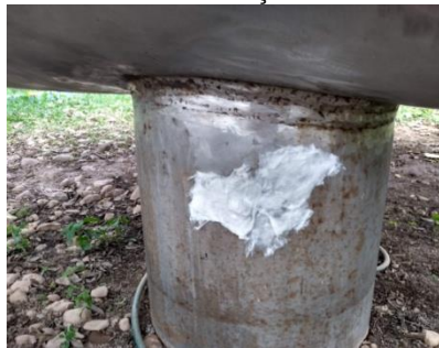
Figura 264 Compressa no cilindro de sustentação.
