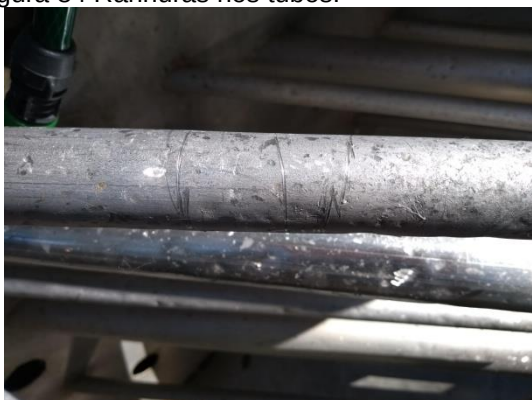
Figura 84 Ranhuras nos tubos.
