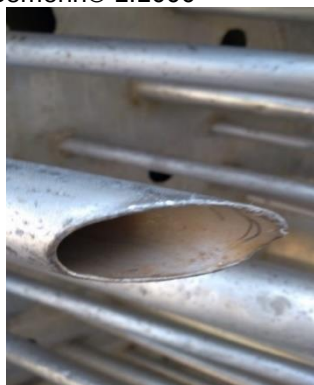
Figura 186 Oxidação tubo antes da aplicação de Semorin® 1:1000
