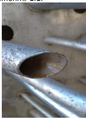
Figura 189 Oxidação tubo antes da aplicação de Semorin® 1:1.
