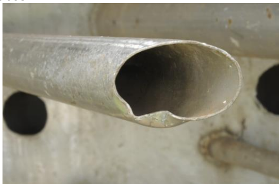
Figura 76 Amassamentos extremidade dos tubos.
