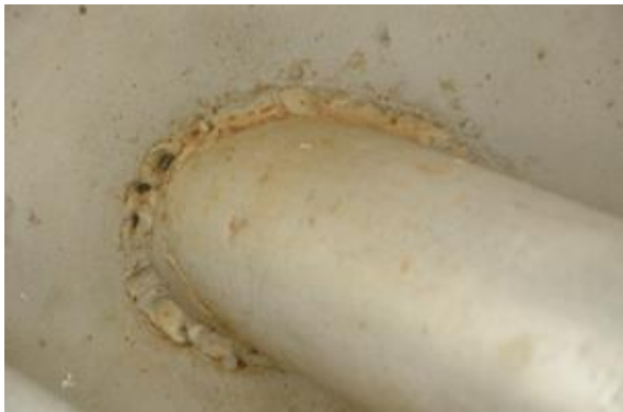
Figura 86 Oxidação na chapa e no entorno da solda.
