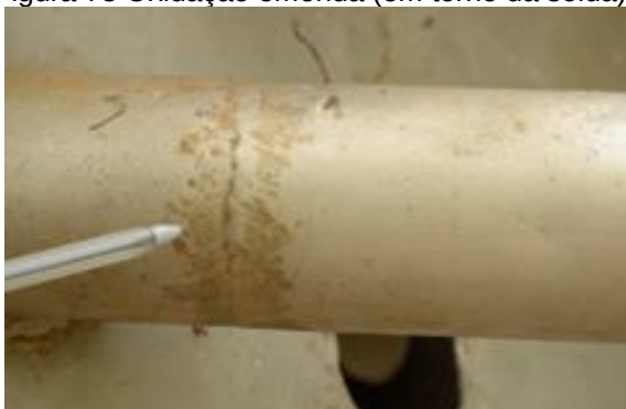
Figura 78 Oxidação emenda (em torno da solda).
