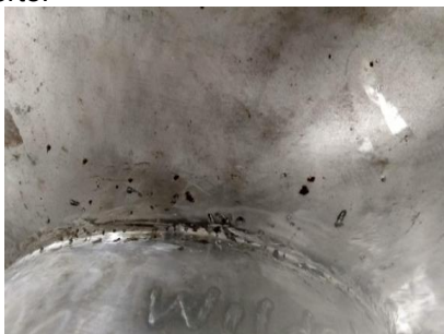
Figura 251 Parte inferior cilindro após compressas com Semorin® com sinais de perda de suporte.
