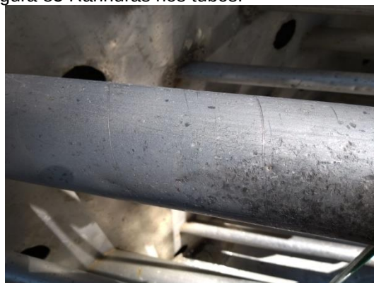
Figura 85 Ranhuras nos tubos.
