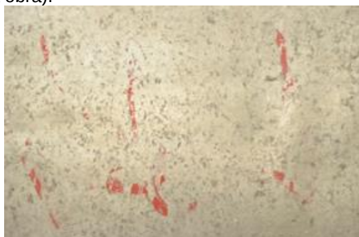
Figura 66 Marcas de impactos (lateral esquerda da obra).
