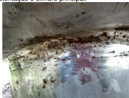
Figura 268 Corrosão solda entre cilindro de sustentação e cilindro principal.
