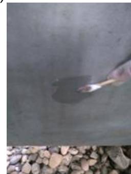
Figura 107 Manchas amareladas removidas com água (lateral esquerda da obra).
