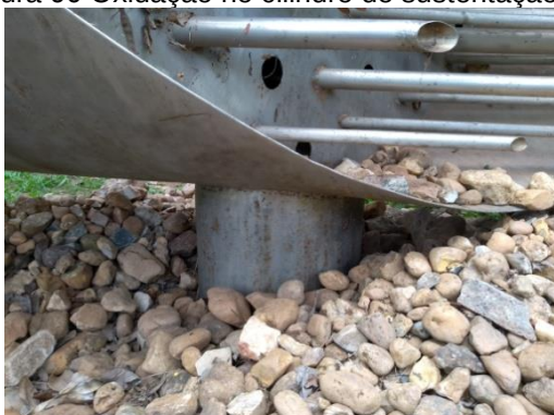
Figura 90 Oxidação no cilindro de sustentação.
