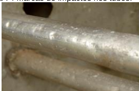
Figura 74 Marcas de impactos nos tubos.
