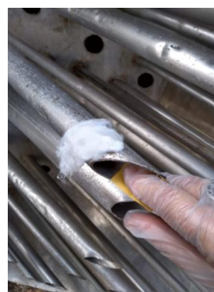
Figura 195 Lixa 1500 sobre oxidação.
