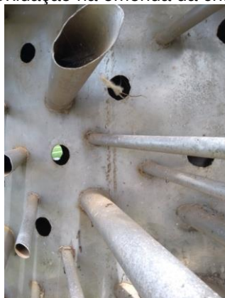
Figura 88 Oxidação na emenda da chapa.
