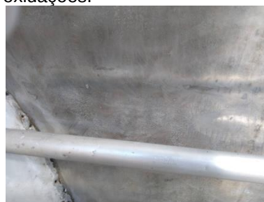
Figura 216 Após remoção de oxidações.
