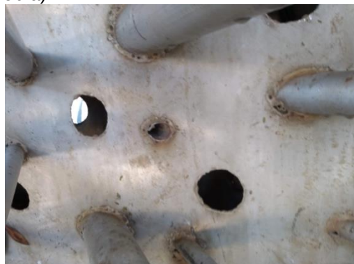
Figura 81 Perda de suporte (tubo) (parte anterior da obra).
