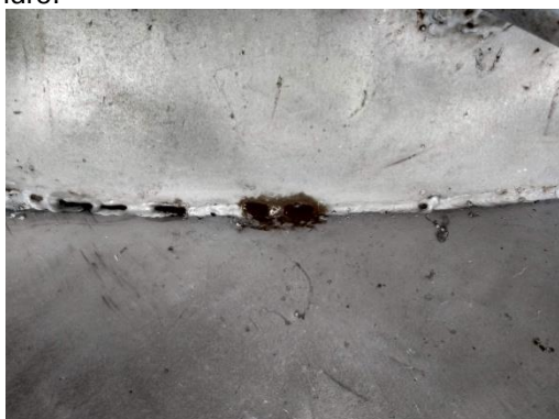
Figura 267 Corrosão junção chapa frontal e cilindro.
