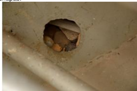
Figura 89 Acúmulo de pedras e detritos entre as chapas.
