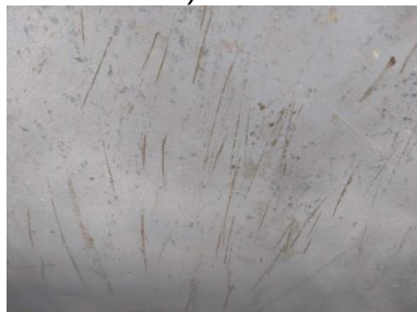
Figura 205 Ranhuras (lateral direita da obra).
