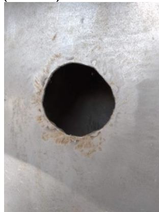
Figura 87 Oxidações nos pontos de ações mecânicas (recortes).
