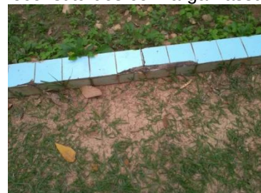
Figura 94 Azulejos quebrados e reconstituídos com argamassa.
