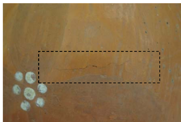
FIGURA 38 – Detalhe de fissuras existente na superfície da peça. Foto: Agesilau Neiva Almada, 2013.
