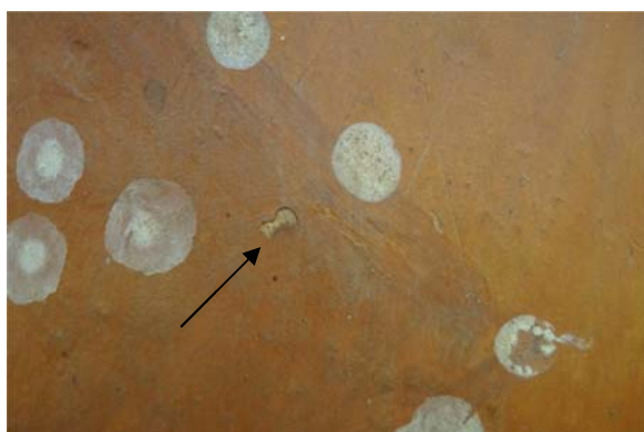
FIGURA 37 – Detalhe da degradação arenado sob a superfície da peça. Foto: Agesilau Neiva Almada, 2013.
