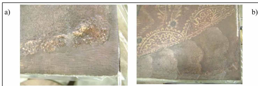
FIGURA 40 - Bordas em processo de reintegração. - a) Borda parcialmente reintegrada; b) Borda com aplicação de pontilhismo para continuidade das nuvens. Créditos: Thaís Carvalho, 2013.
