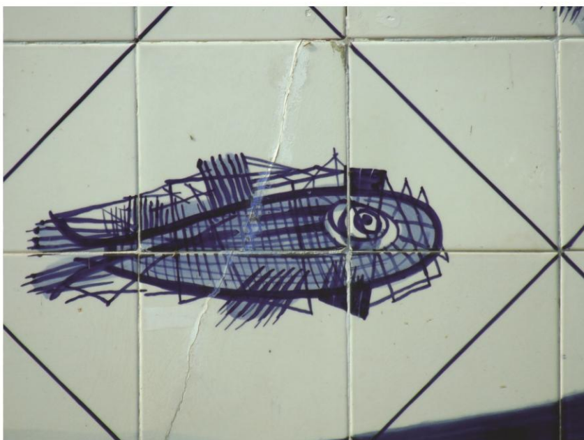
AZULEJO D 57: REINTEGRAÇÃO INADEQUADA
