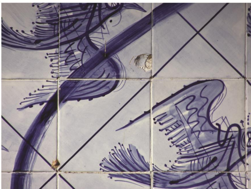
AZULEJO O 90: PERDA DO CORPO CERÂMICO
