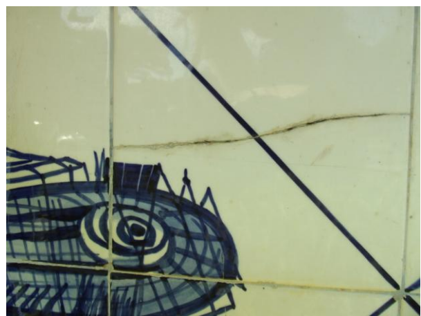
FIGURA 18 – Detalhe do painel:Trinca no azulejo B 54
