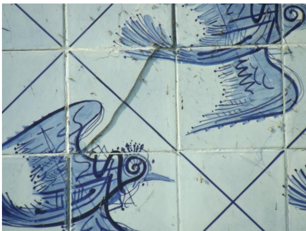
FIGURA 17 - Detalhe do painel: Trinca no azulejo Q 63
