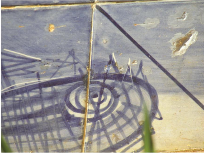
AZULEJO A 144: INTERVENÇÃO INADEQUADA
