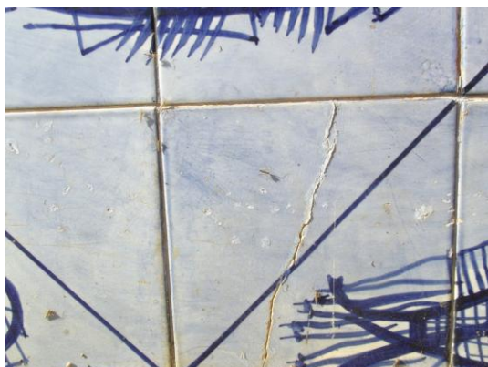
FIGURA 19– Detalhe do painel: intervenção inadequada.
