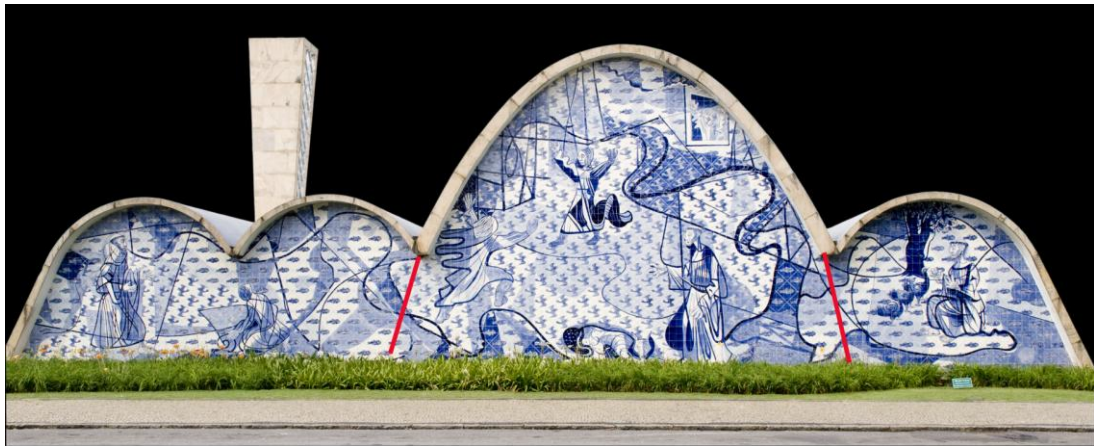
FIGURA 16: Fotografia do painel com marcações das regiões das trincas em vermelho
