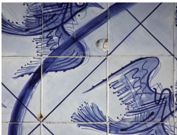
FIGURA 22 – Detalhe do painel: azulejo (O 90) com perda de camada cerâmica
