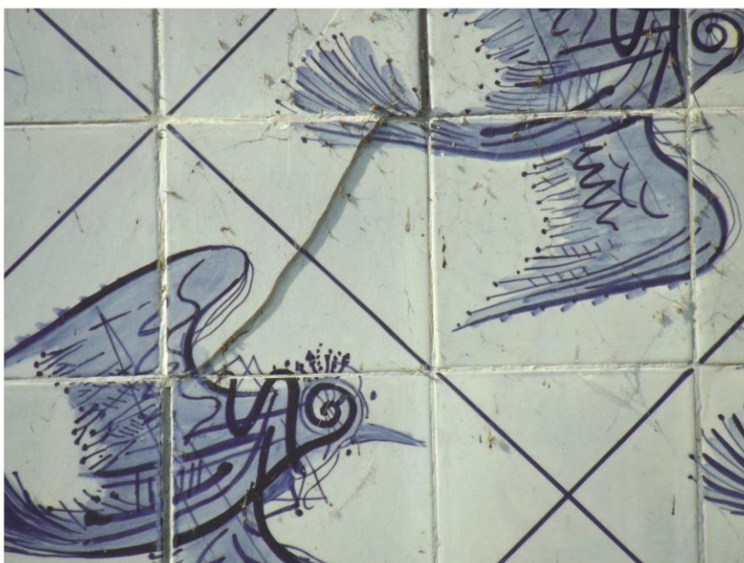
AZULEJO Q 63: TRINCA
