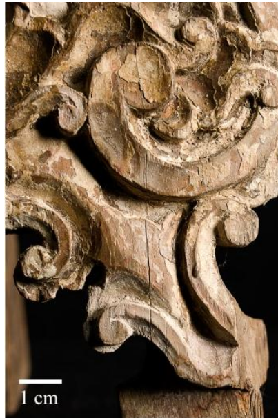
FIGURA 17: Fissura no Suporte
